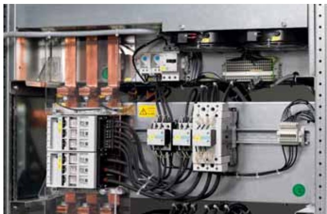
Модуль конденсаторов 100 кВАр
