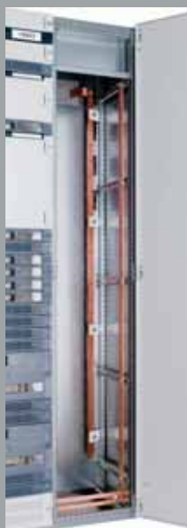
Вертикальные шины PE располагаются в отсеке кабельных подключений справа
